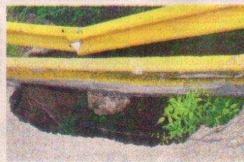
LA LLUVIA que ha caído en los últimos días ha acelerado el deterioro de la vía a El Rodadero.
