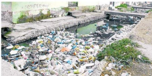
Las aguas negras estancadas y las basuras son la constante en el canal de Las Maravillas. # FOTOS: ZENA VALDELLAMAR
