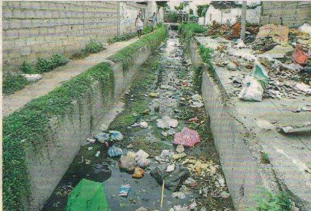
LA MAYORÍA DE CANALES en la ciudad están bastante contaminados, lo que generaría inundaciones en caso de fuertes lluvias. //LUIS APARICIO-EL UNIVERSAL
