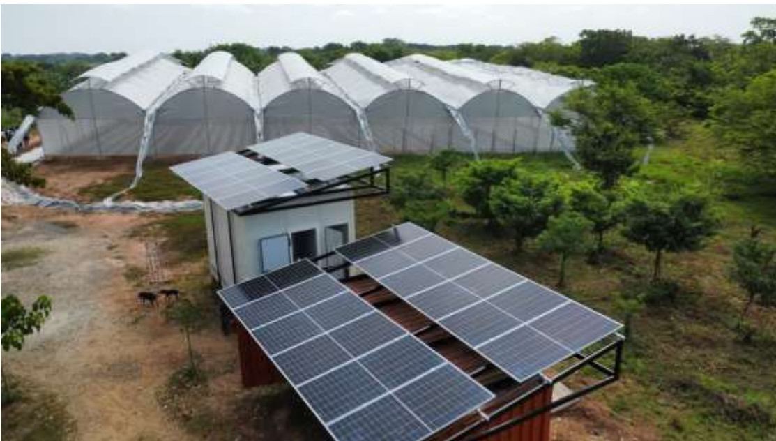
Ilustración 14. Instalaciones de uno de los Viveros construidos en el Departamento de Magdalena. Fuente: Jefatura de Investigación y Creación
